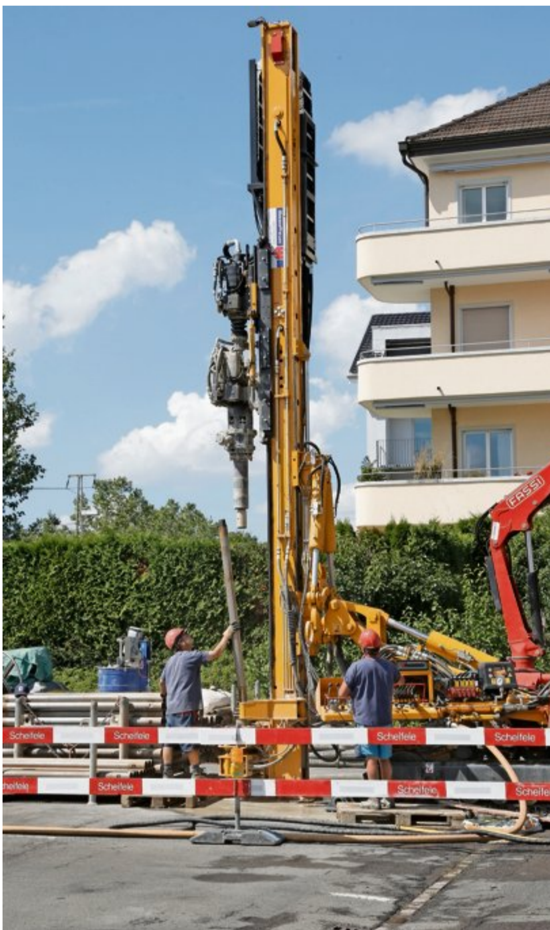
Die Arbeiter müssen die Stangen, welche in den Boden getrieben werden, regelmässig austauschen. Bilder Sabine Rock
