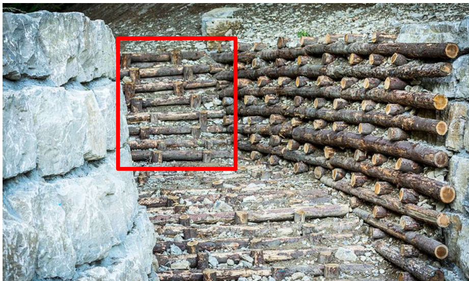
Abbildung 21: Naturnaher Ausbau als temporäre Baugrubensicherung mit horizontalen und vertikalen Holzpflocken, Quelle Bild: Naturnaher Ausbau von zwei Klingen in Forchtenberg (i-mo-ti-on.de)
